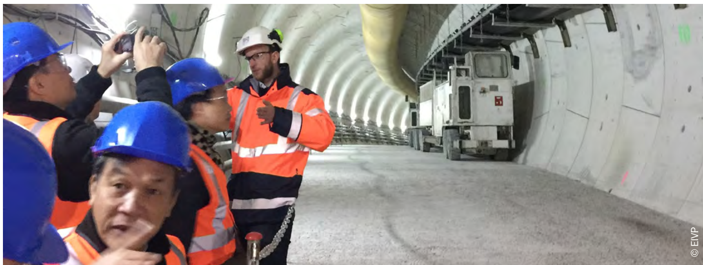
La visite du chantier de l'extension de la ligne 14, organisée par Gexpertise, fut une opportunité exceptionnelle pour illustrer le volet technique inhérent au thème de ce séminaire
