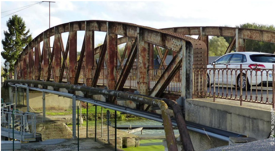
Le vieux pont métallique de Tergnier emprunté chaque jour par des centaines d'automobilistes.
