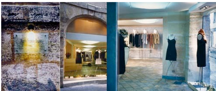
Réaménagement et décoration d'un magasin de prêt-à-porter Lionel Loris, Maître d'œuvre eOspace, Paris
